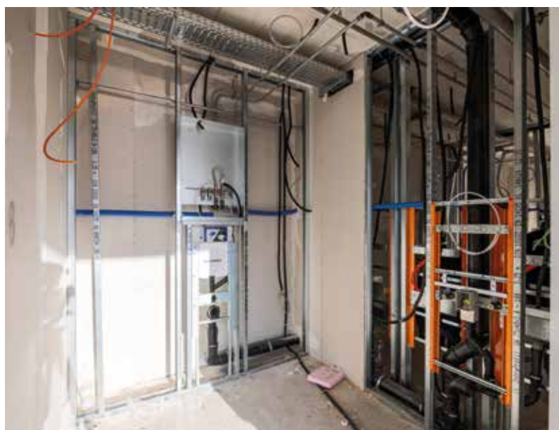
Die Sport Arena Wien verfügt über Sanitäreinrichtungen, die auf hohe Besucherfrequenzen ausgelegt sind.
