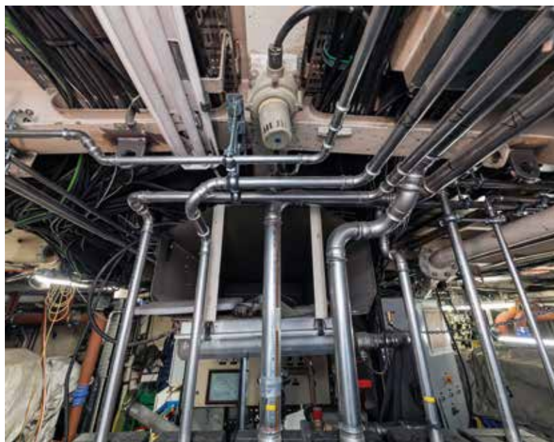
Ein Blick in den Maschinenraum zeigt: Hier wird Mapress auch für Treibstoff-, AdBlue-, Kälte- und Heizungsverrohrung verwendet.
